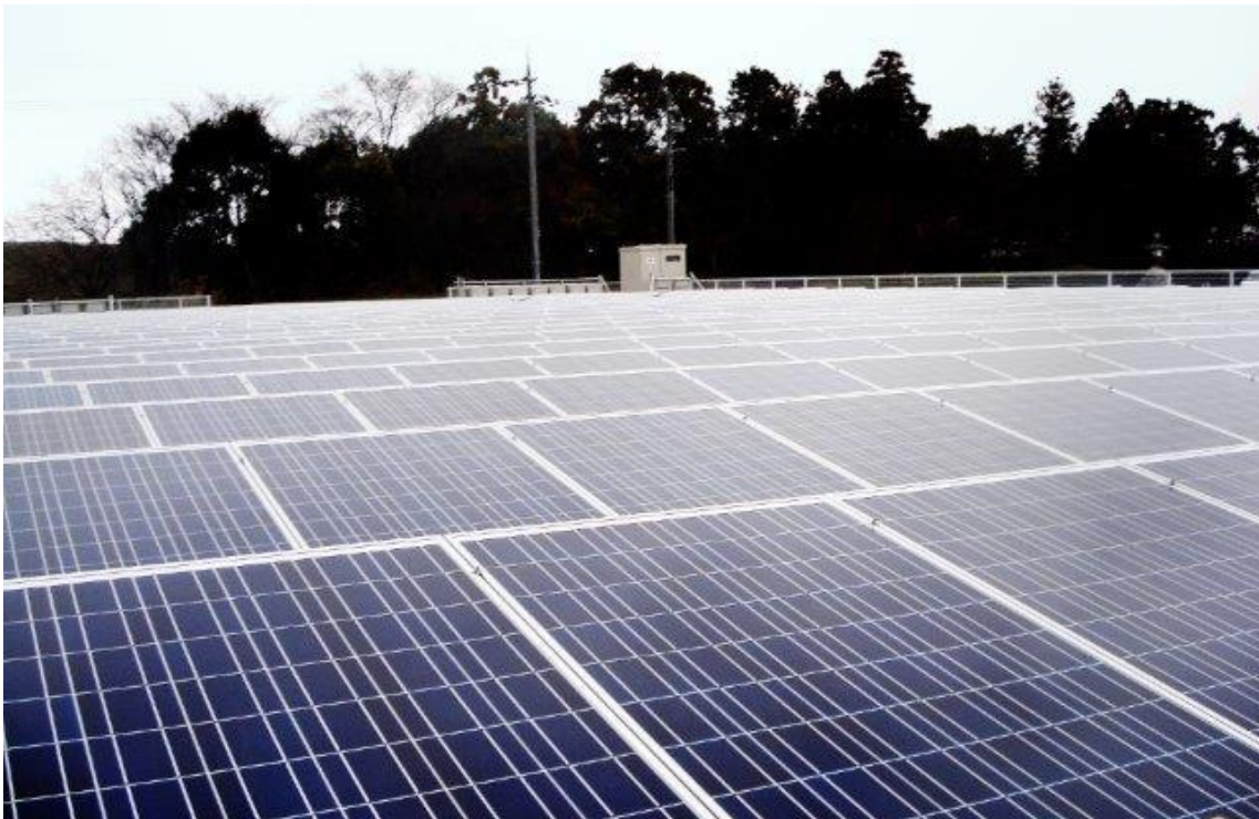
新栄電設工業 発電所
