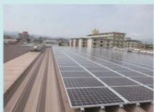
写真はコープみみなしの屋上に設置された太陽光発電です。
